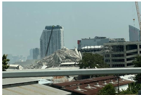
อาคารถล่มระหว่างการก่อสร้างที่ย่านจตุจักร (ภาพถ่ายโดยผู้เขียนเมื่อวันที่ 29 มีนาคม 2568)
